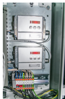
Obě vyhodnocovací jednotky jsou umístěny v tepelně méně kritické oblasti v samostatném krytu rotační pece.
