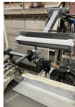
Eine zweite Kamera, ebenfalls mit einer Industrielleuchte der Reihe EM51 von IPF, befindet sich an der Produktionslinie für den Grundputz.
