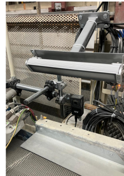
Una segunda cámara, también con una luz industrial del EM51 de IPF, está situada en la línea de producción de la escayola básica.
