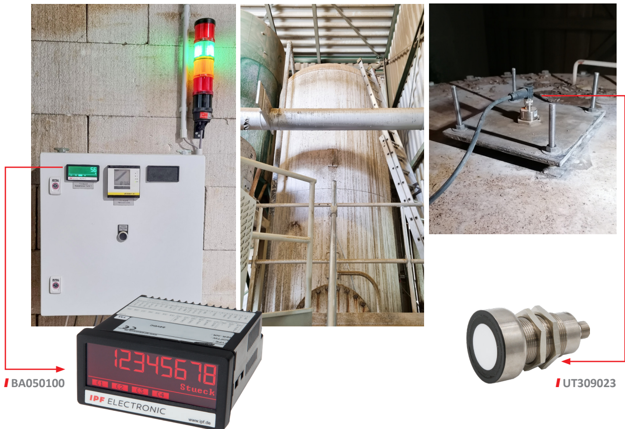
Der Ultraschallsender wurde im Deckelbereich eines Silobehälters montiert (rechts). Der Messumformer (links) befindet sich in einem Schaltschrank, in der Nähe des Silos (Mitte).
