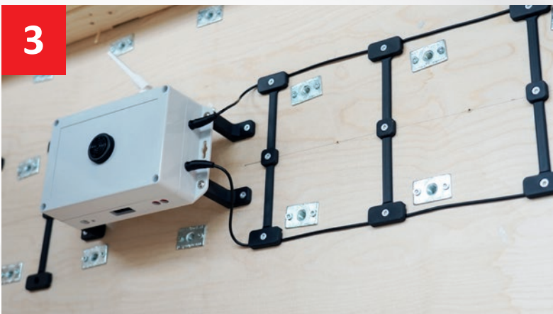
3 Fertig installierte Elektroden für eine Kletterlinie
