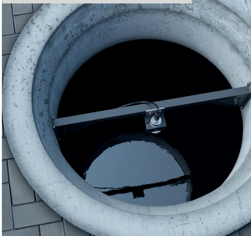
Überwachung des Zisternenfüllstandes
