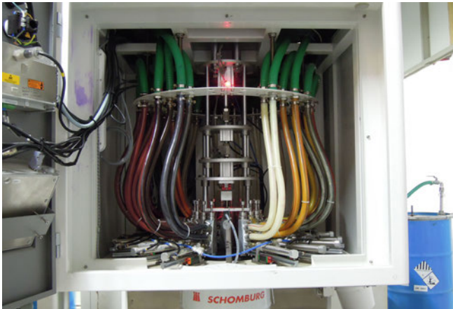
ipf_Schomburg_002: An der zweiten Station der Automationslinie von Schomburg erfolgt die Dosierung der Farbe für die Industrie-Bodenbeschichtungen.
