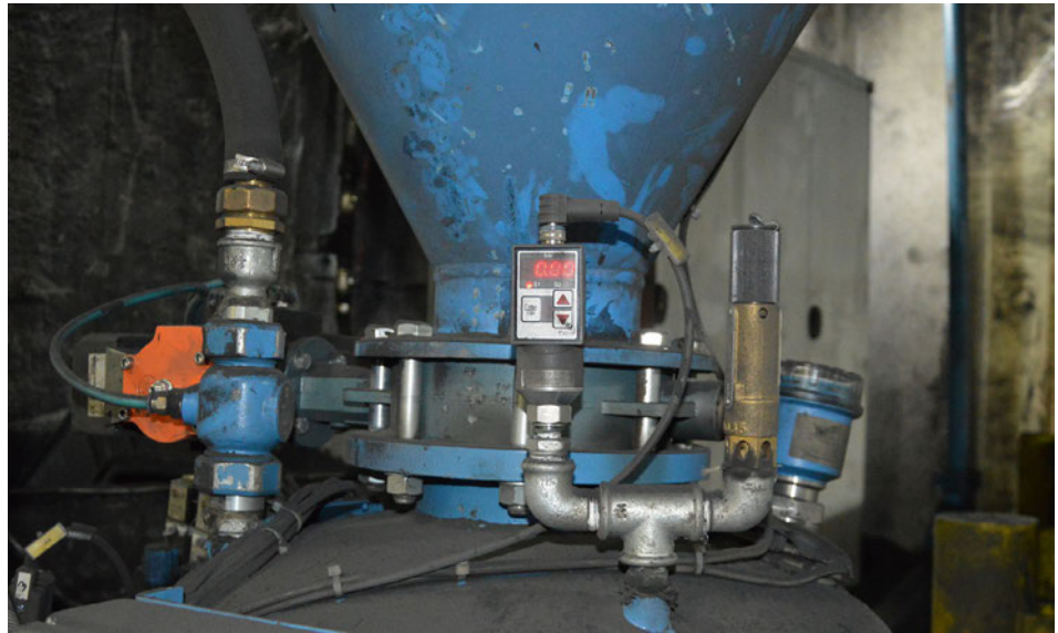
Drucksensoren der Reihe DW34, DW35 und DW36 eignen sich für verschiedenste Druckmessungen von Gasen und Flüssigkeiten. Hier ein Drucksensor der Reihe DW35 zur Überwachung einer mit Pressluft gefüllten Transportleitung für Staub, der beim Sphäroguss entsteht und in ein Silo abgeführt wird.
