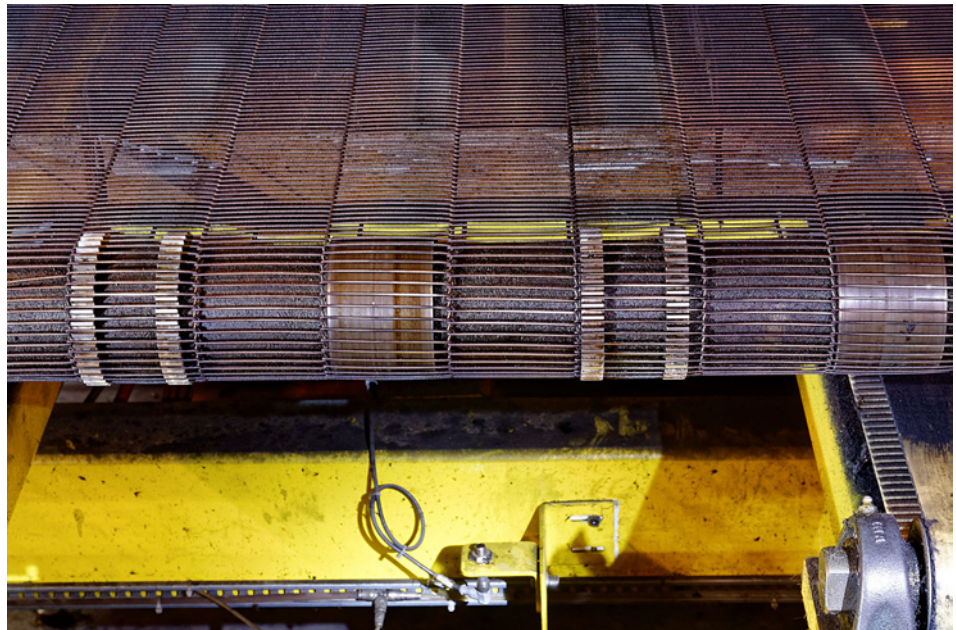
Aufgrund ihrer hohen Reichweite konnte die Lichtschranke in einem thermisch unkritischen Bereich des Förderbandes montiert werden.
