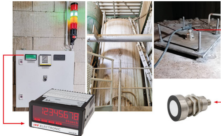
Der Ultraschalltaster wurde in dieser Applikation im Deckelbereich eines Silobehälters montiert (rechts). Der Messumformer (links) befindet sich in einem Schaltschrank, in der Nähe des Silos (Mitte).
