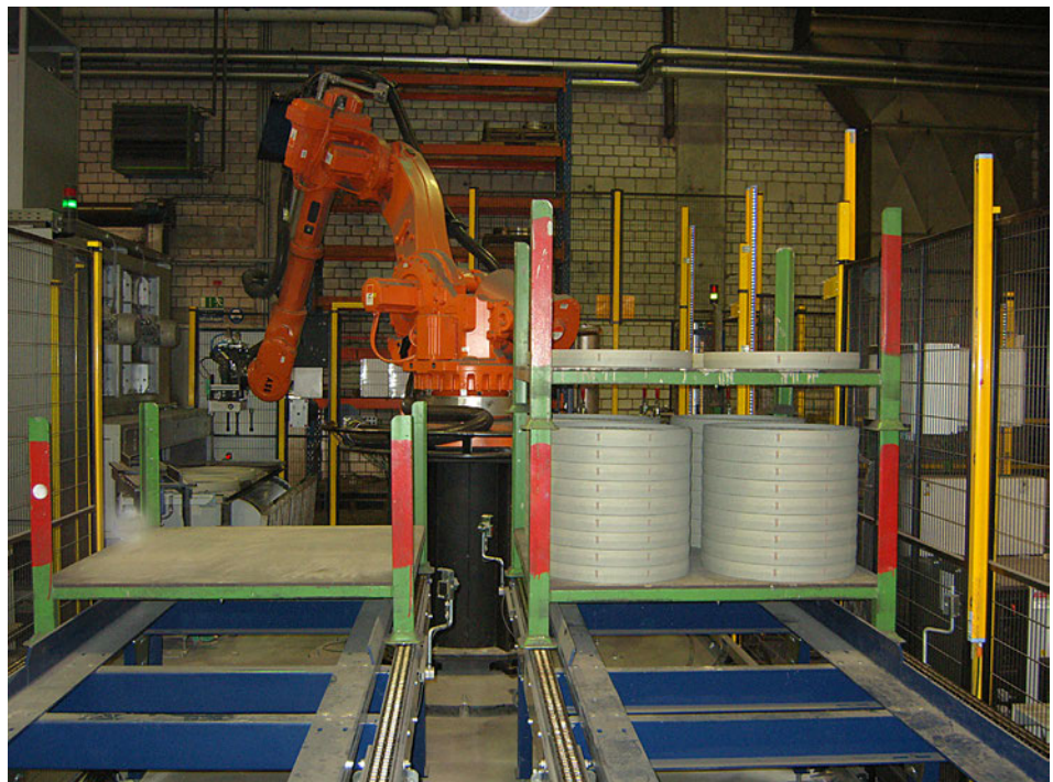
Abb. 21: Das Gesamtsystem ist in einen äußeren und inneren Schutzbereich aufgeteilt. Um die Transportgestelle ungehindert dem Automationsprozess zuzuführen, sind die äußeren Sicherheitslichtgitter mit einer Mutingfunktion versehen.
