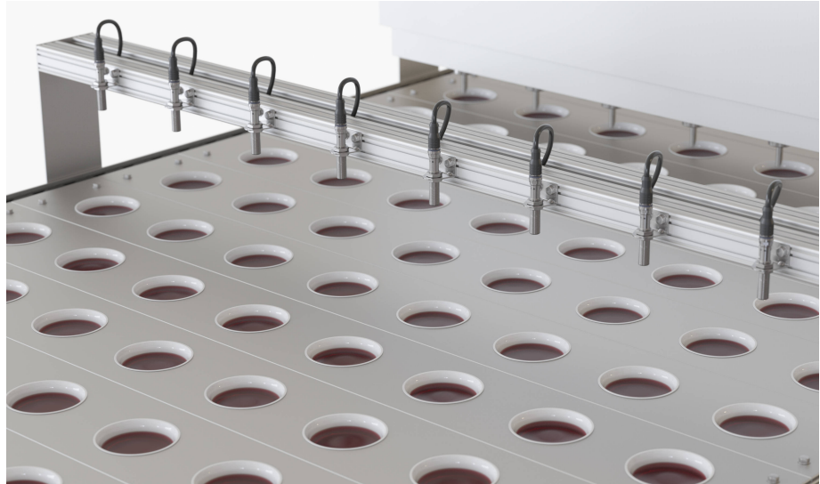
IO-Link-Ultraschallsensoren mit Analogausgang zur Füllstandkontrolle an einer Abfüllstation: In dieser Applikation können die Sensoren sowohl im Synchronisations- als auch Multiplexbetrieb arbeiten.
